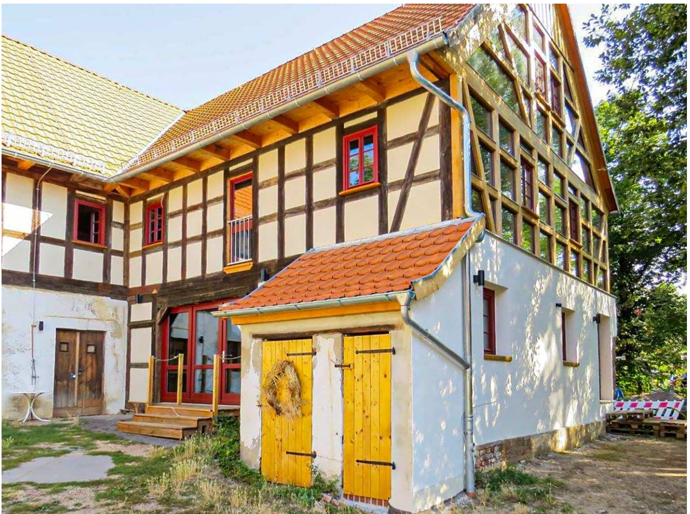
Die Gräfenmühle mit ihrem behutsam in Lehm- und Holzbau sanierten Winkelbau mit Kulturscheune ©LPV Westsachsen
